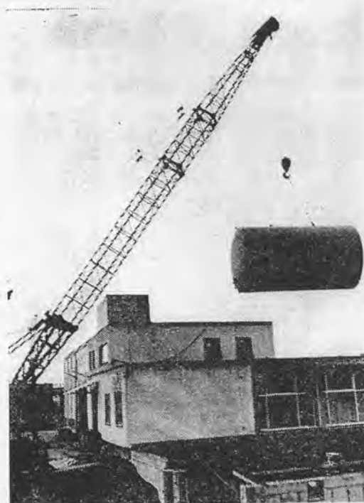
Ein Hebekran der Firma Link, Bensheim-Auerbach, schwenkt einen 41 000-Liter-Tank über das Dach der Gebietswinzergenossenschaft.
