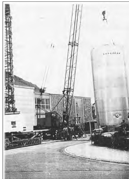
Einbringen eines Stahltanks, 125.000 Ltr. Inhalt, bei der Baumaßnahme 1974 zur Erweiterung der Lagerkapazität um 1,7 auf 4,2 Mill. Ltr.
